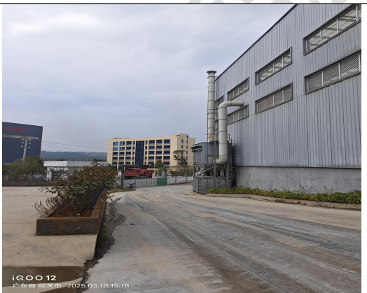
炉渣处理车间废气排气筒 DA001
