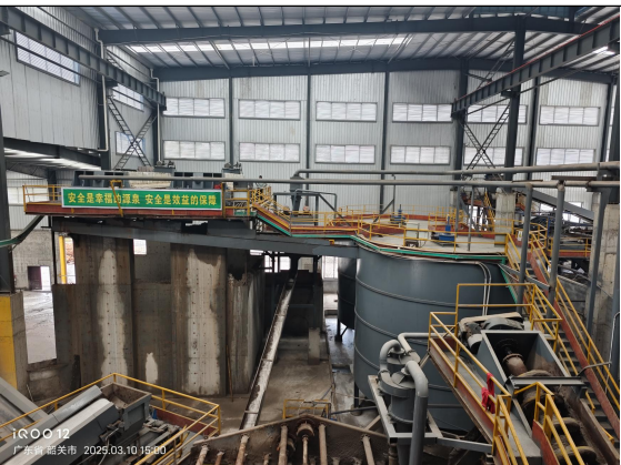
炉渣处理设备及废水沉淀设备
