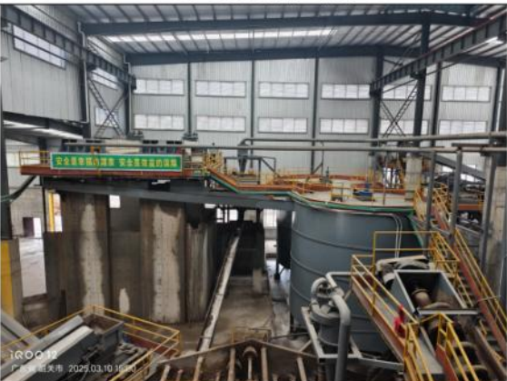
炉渣处理设备及废水沉淀设备
