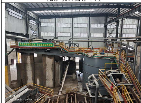
炉渣处理设备及废水沉淀设备
