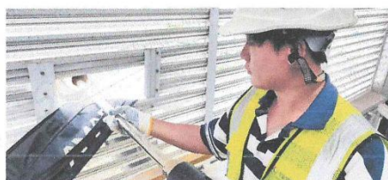
炉渣处理车间工艺废气排放口(DA001)
